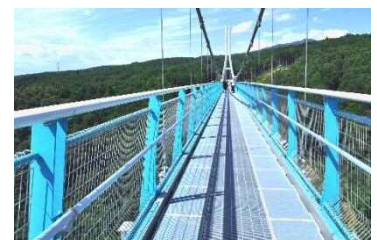
グレーチング使用例
