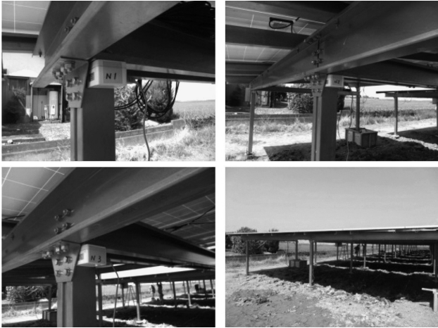
写真 12. 加速度計設置状況
