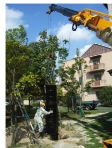
地中熱利用タンク
