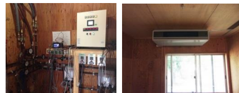
自動制御装置
